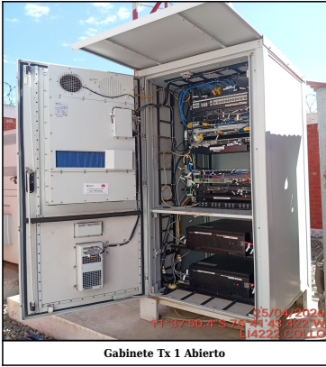
Gabinete Tx 1 Abierto
