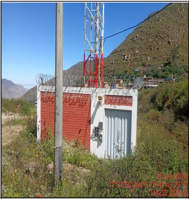
Pozo a tierra
