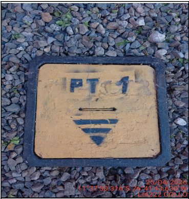
Pozo a tierra
