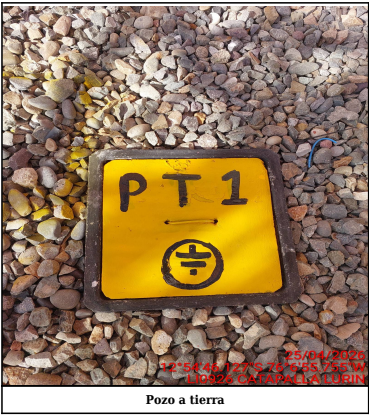
Pozo a tierra
