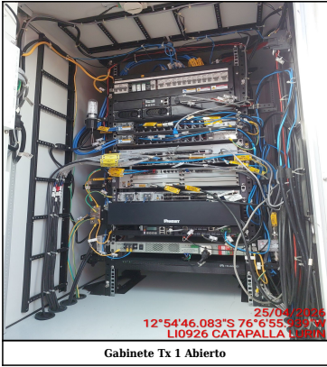
Gabinete Tx 1 Abierto
