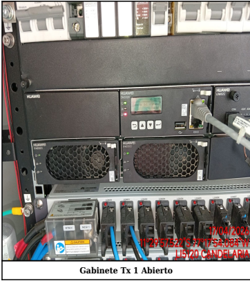
Gabinete Tx 1 Abierto
