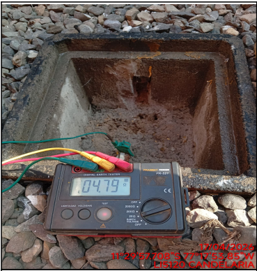
Pozo a tierra
