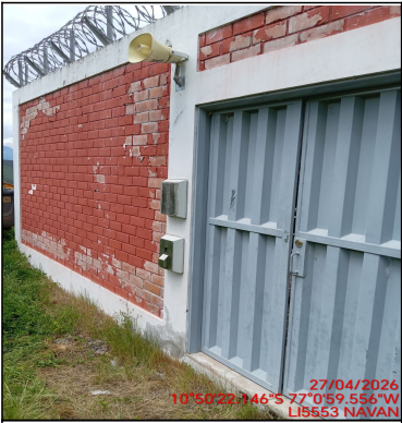
Pozo a tierra
