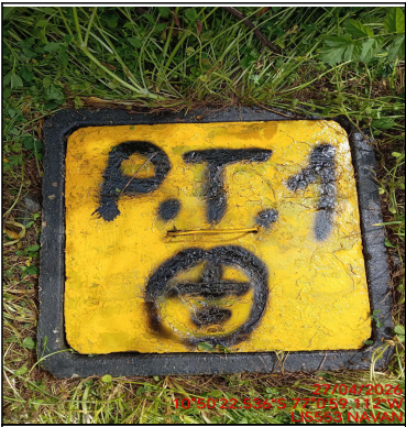
Pozo a tierra
