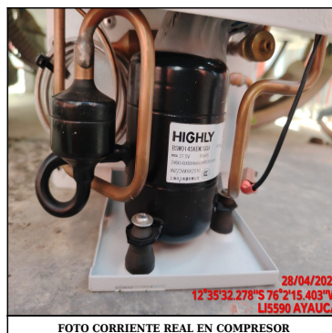
FOTO CORRIENTE REAL EN COMPRESOR
