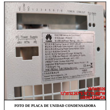
FOTO DE PLACA DE UNIDAD CONDENSADORA
