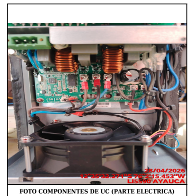
FOTO COMPONENTES DE UC (PARTE ELECTRICA)
