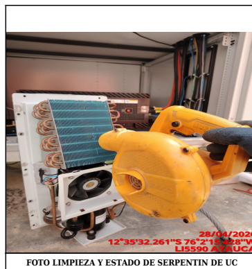
FOTO LIMPIEZA Y ESTADO DE SERPENTIN DE UC
