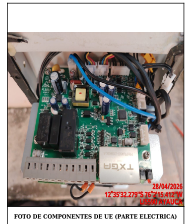
FOTO DE COMPONENTES DE UE (PARTE ELECTRICA)
