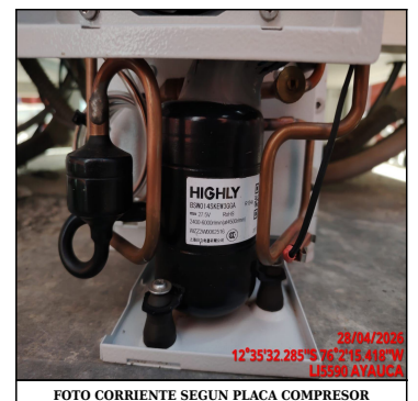
FOTO CORRIENTE SEGUN PLACA COMPRESOR
