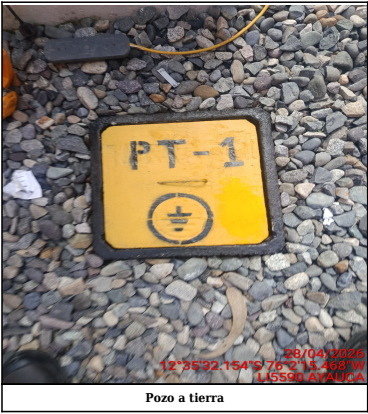
Pozo a tierra
