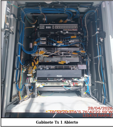
Gabinete Tx 1 Abierto
