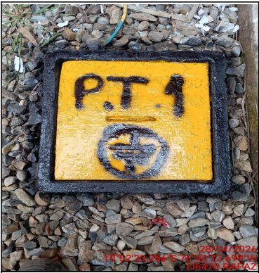
Pozo a tierra
