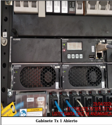
Gabinete Tx 1 Abierto
