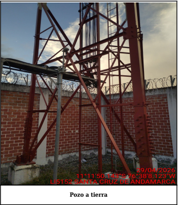
Pozo a tierra
