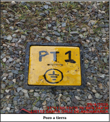
Pozo a tierra
