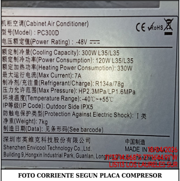
FOTO CORRIENTE SEGUN PLACA COMPRESOR
