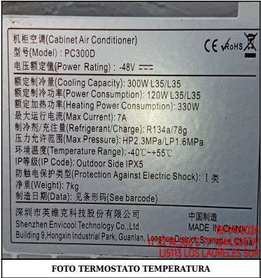
FOTO TERMOSTATO TEMPERATURA
