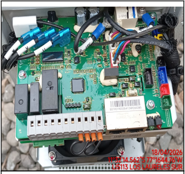
FOTO COMPONENTES DE UC (PARTE ELECTRICA)
