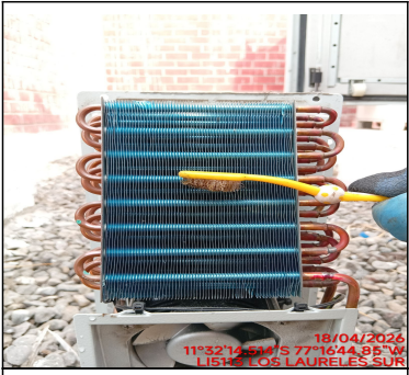
FOTO LIMPIEZA Y ESTADO DE SERPENTIN DE UC
