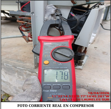
FOTO CORRIENTE REAL EN COMPRESOR
