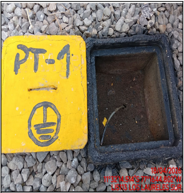
Pozo a tierra
