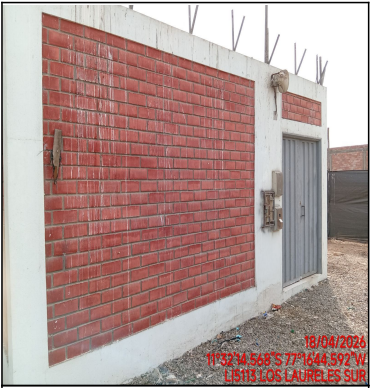
Pozo a tierra
