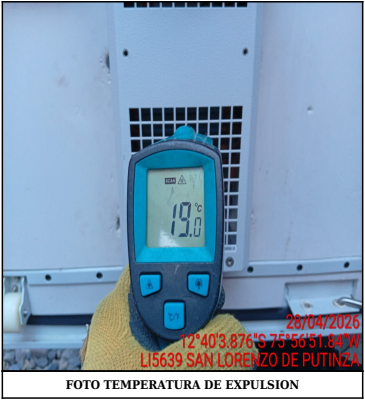
FOTO TEMPERATURA DE EXPULSION
