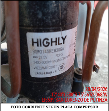
FOTO CORRIENTE SEGUN PLACA COMPRESOR
