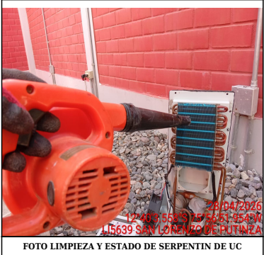
FOTO LIMPIEZA Y ESTADO DE SERPENTIN DE UC
