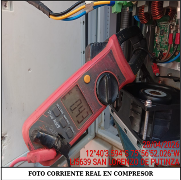
FOTO CORRIENTE REAL EN COMPRESOR
