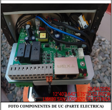
FOTO COMPONENTES DE UC (PARTE ELECTRICA)
