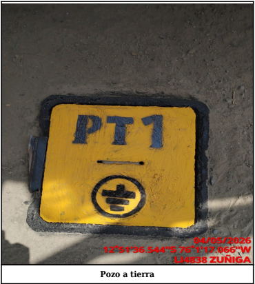
Pozo a tierra
