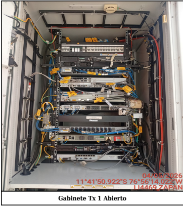
Gabinete Tx 1 Abierto
