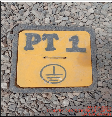
Pozo a tierra
