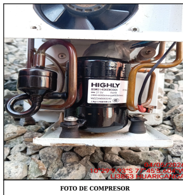
FOTO DE COMPRESOR
