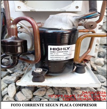
FOTO CORRIENTE SEGUN PLACA COMPRESOR
