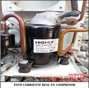
FOTO CORRIENTE REAL EN COMPRESOR
