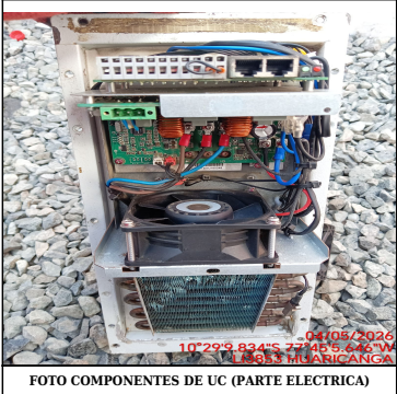
FOTO COMPONENTES DE UC (PARTE ELECTRICA)
