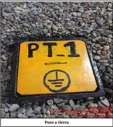
Pozo a tierra
