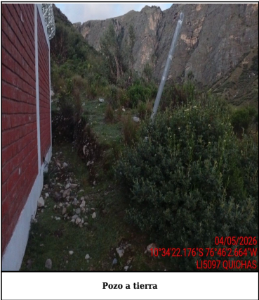
Pozo a tierra
