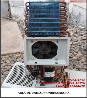
AREA DE UNIDAD CONDENSADORA
