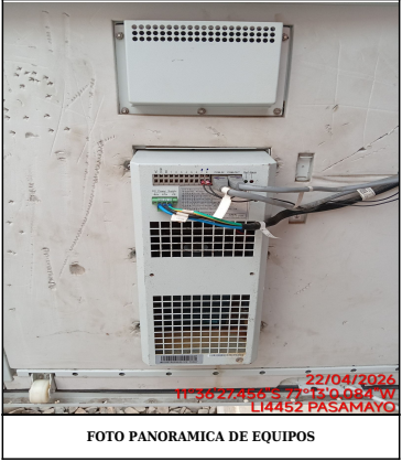
FOTO PANORAMICA DE EQUIPOS
