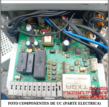
FOTO COMPONENTES DE UC (PARTE ELECTRICA)
