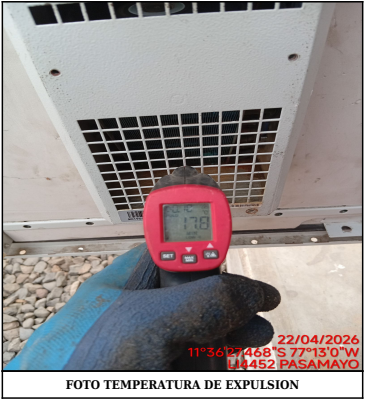
FOTO TEMPERATURA DE EXPULSION
