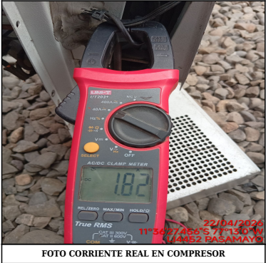
FOTO CORRIENTE REAL EN COMPRESOR
