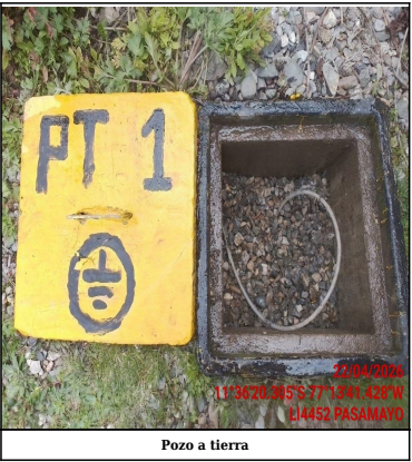
Pozo a tierra
