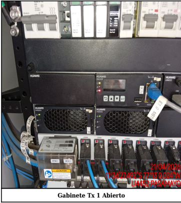
Gabinete Tx 1 Abierto
