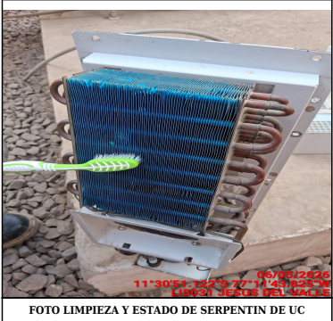
FOTO LIMPIEZA Y ESTADO DE SERPENTIN DE UC
