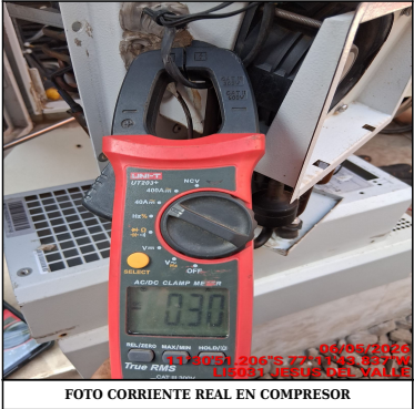
FOTO CORRIENTE REAL EN COMPRESOR
