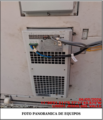
FOTO PANORAMICA DE EQUIPOS
