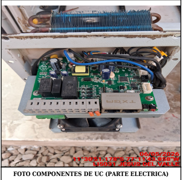
FOTO COMPONENTES DE UC (PARTE ELECTRICA)
