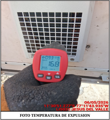
FOTO TEMPERATURA DE EXPULSION
