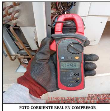
FOTO CORRIENTE REAL EN COMPRESOR
