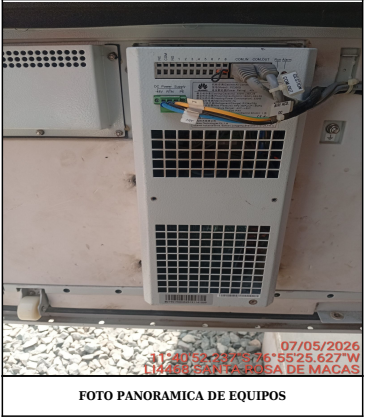
FOTO PANORAMICA DE EQUIPOS
