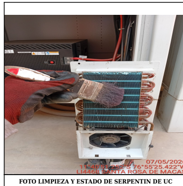
FOTO LIMPIEZA Y ESTADO DE SERPENTIN DE UC
