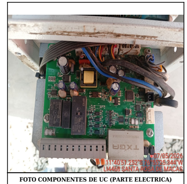
FOTO COMPONENTES DE UC (PARTE ELECTRICA)
