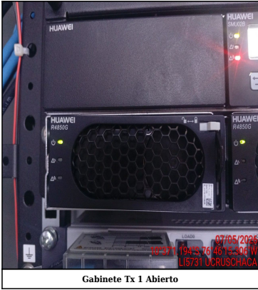
Gabinete Tx 1 Abierto
