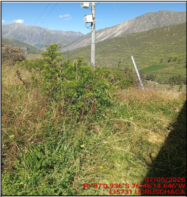
Pozo a tierra
