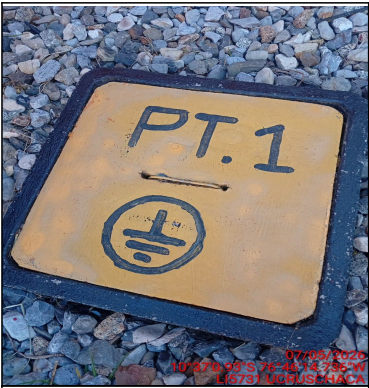
Pozo a tierra
