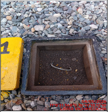
Pozo a tierra
