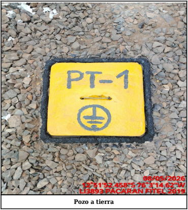
Pozo a tierra
