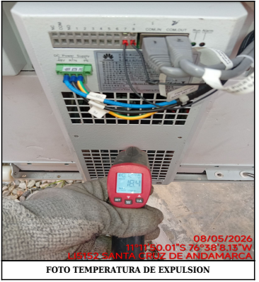
FOTO TEMPERATURA DE EXPULSION
