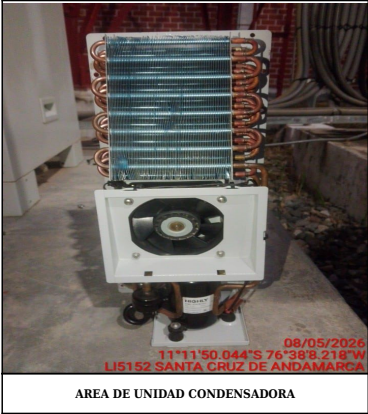
AREA DE UNIDAD CONDENSADORA
