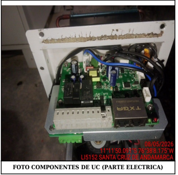
FOTO COMPONENTES DE UC (PARTE ELECTRICA)
