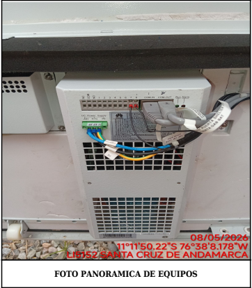
FOTO PANORAMICA DE EQUIPOS
