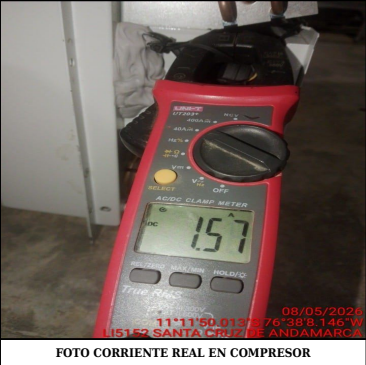
FOTO CORRIENTE REAL EN COMPRESOR
