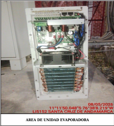
AREA DE UNIDAD EVAPORADORA
