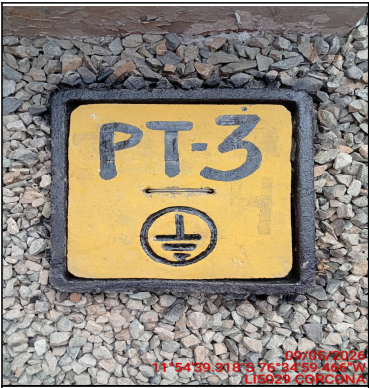
Pozo a tierra
