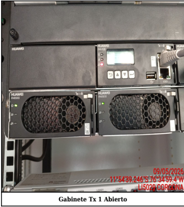
Gabinete Tx 1 Abierto
