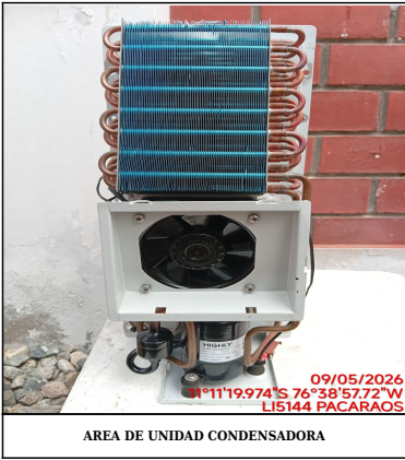
AREA DE UNIDAD CONDENSADORA
