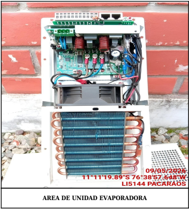
AREA DE UNIDAD EVAPORADORA
