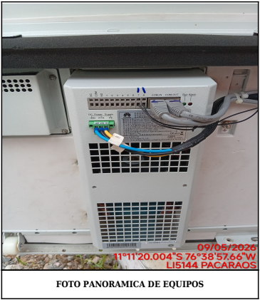
FOTO PANORAMICA DE EQUIPOS
