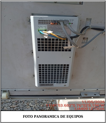
FOTO PANORAMICA DE EQUIPOS
