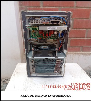
AREA DE UNIDAD EVAPORADORA
