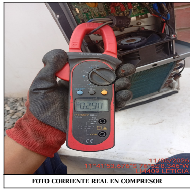
FOTO CORRIENTE REAL EN COMPRESOR
