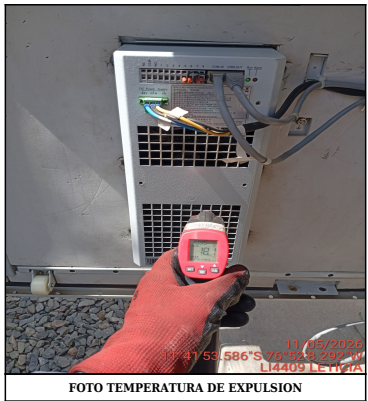
FOTO TEMPERATURA DE EXPULSION
