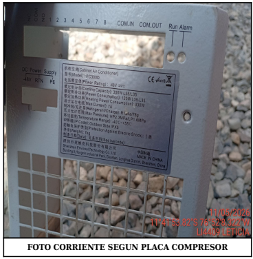
FOTO CORRIENTE SEGUN PLACA COMPRESOR
