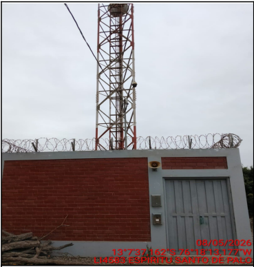
Pozo a tierra
