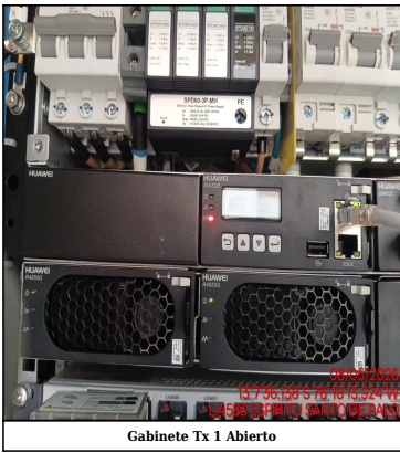
Gabinete Tx 1 Abierto
