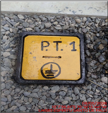
Pozo a tierra
