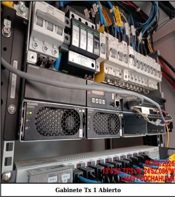
Gabinete Tx 1 Abierto
