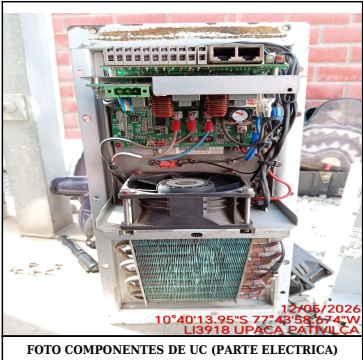
FOTO COMPONENTES DE UC (PARTE ELECTRICA)
