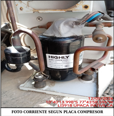
FOTO CORRIENTE SEGUN PLACA COMPRESOR
