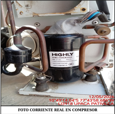
FOTO CORRIENTE REAL EN COMPRESOR
