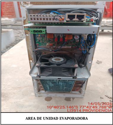
AREA DE UNIDAD EVAPORADORA
