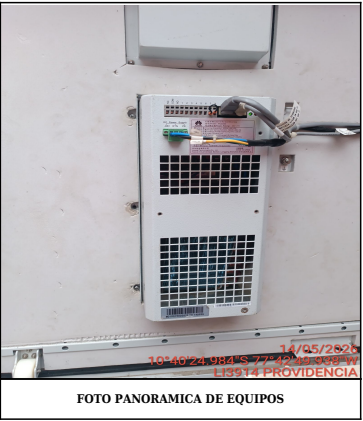
FOTO PANORAMICA DE EQUIPOS
