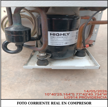
FOTO CORRIENTE REAL EN COMPRESOR
