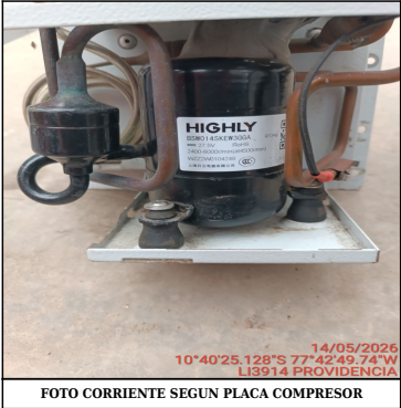
FOTO CORRIENTE SEGUN PLACA COMPRESOR
