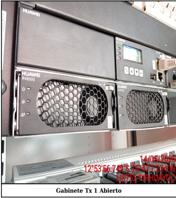
Gabinete Tx 1 Abierto
