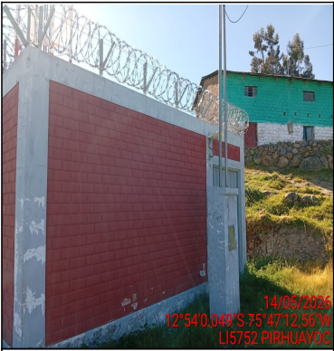
Pozo a tierra
