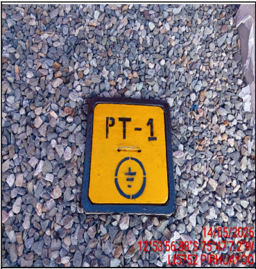
Pozo a tierra
