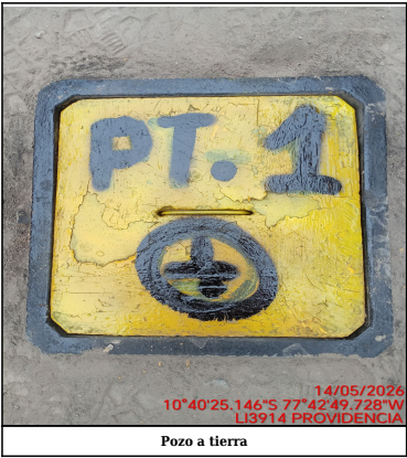
Pozo a tierra
