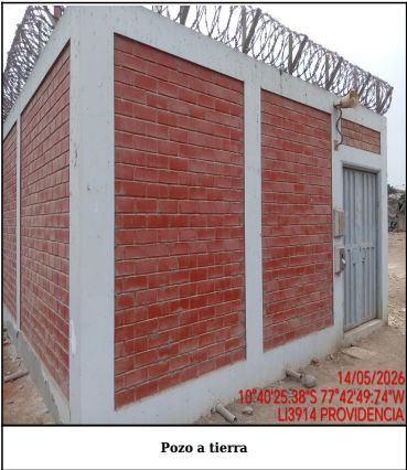
Pozo a tierra
