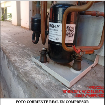
FOTO CORRIENTE REAL EN COMPRESOR
