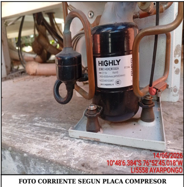
FOTO CORRIENTE SEGUN PLACA COMPRESOR
