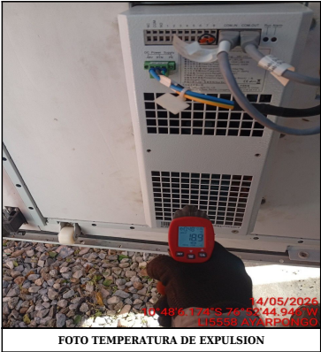
FOTO TEMPERATURA DE EXPULSION
