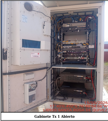
Gabinete Tx 1 Abierto
