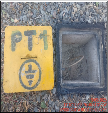
Pozo a tierra
