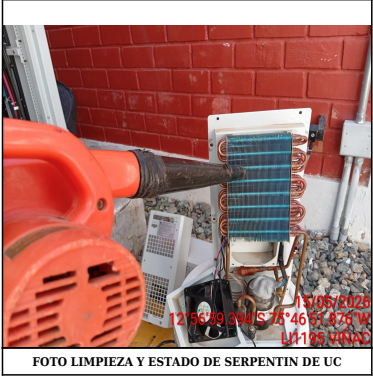
FOTO LIMPIEZA Y ESTADO DE SERPENTIN DE UC
