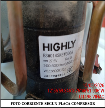
FOTO CORRIENTE SEGUN PLACA COMPRESOR
