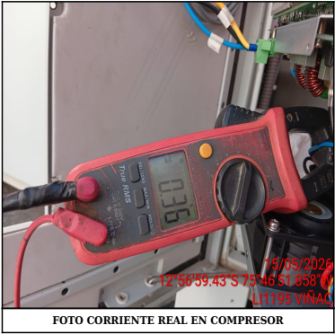
FOTO CORRIENTE REAL EN COMPRESOR
