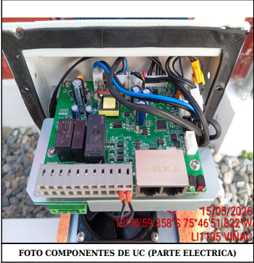
FOTO COMPONENTES DE UC (PARTE ELECTRICA)
