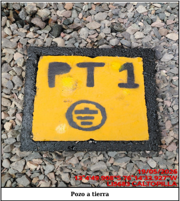
Pozo a tierra
