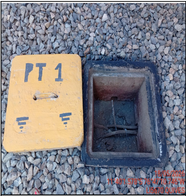
Pozo a tierra
