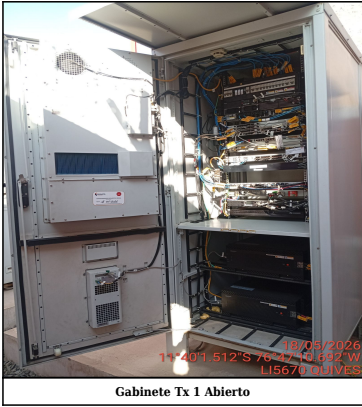
Gabinete Tx 1 Abierto
