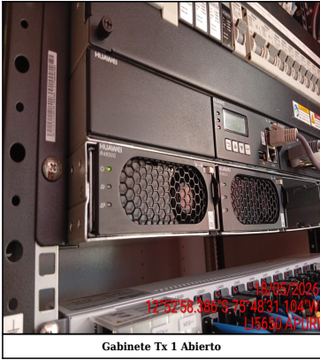
Gabinete Tx 1 Abierto
