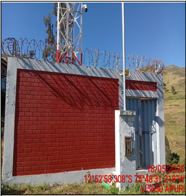
Pozo a tierra
