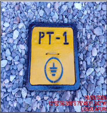
Pozo a tierra
