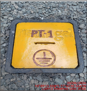
Pozo a tierra
