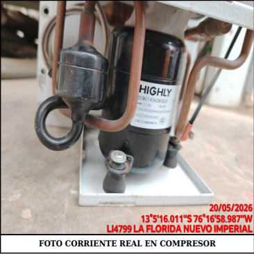
FOTO CORRIENTE REAL EN COMPRESOR
