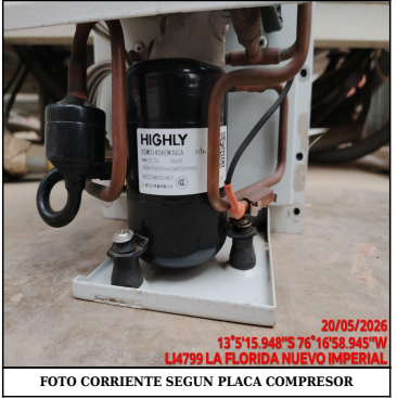
FOTO CORRIENTE SEGUN PLACA COMPRESOR
