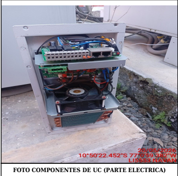
FOTO COMPONENTES DE UC (PARTE ELECTRICA)
