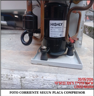
FOTO CORRIENTE SEGUN PLACA COMPRESOR
