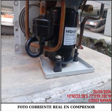
FOTO CORRIENTE REAL EN COMPRESOR
