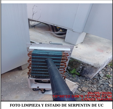
FOTO LIMPIEZA Y ESTADO DE SERPENTIN DE UC
