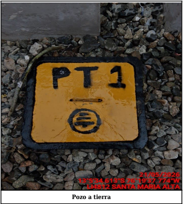
Pozo a tierra
