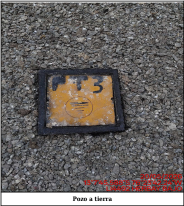
Pozo a tierra
