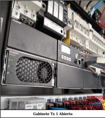
Gabinete Tx 1 Abierto
