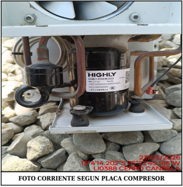
FOTO CORRIENTE SEGUN PLACA COMPRESOR
