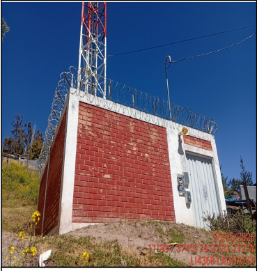
Pozo a tierra
