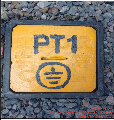
Pozo a tierra
