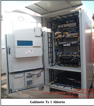
Gabinete Tx 1 Abierto
