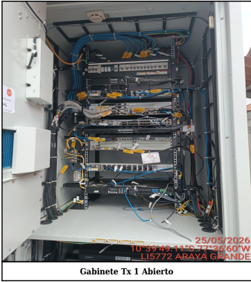
Gabinete Tx 1 Abierto
