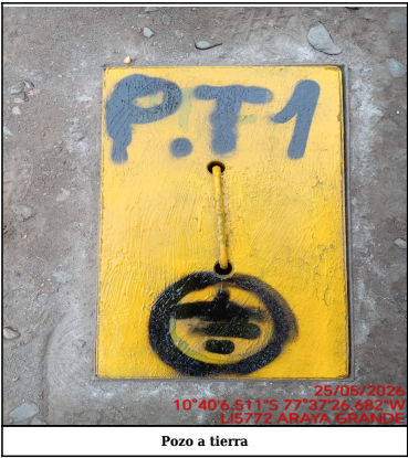
Pozo a tierra
