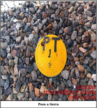
Pozo a tierra
