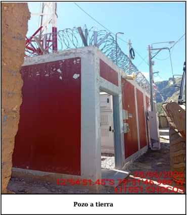
Pozo a tierra
