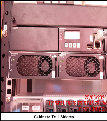
Gabinete Tx 1 Abierto
