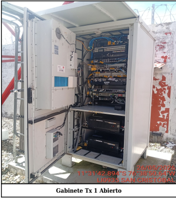
Gabinete Tx 1 Abierto
