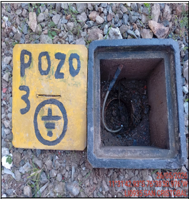
Pozo a tierra
