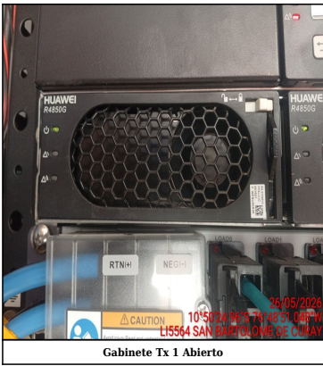
Gabinete Tx 1 Abierto
