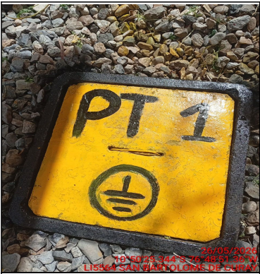
Pozo a tierra
