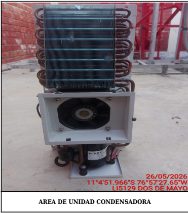
AREA DE UNIDAD CONDENSADORA
