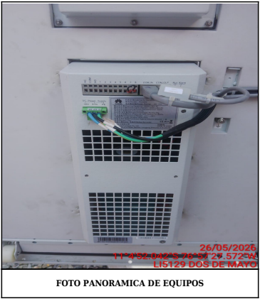
FOTO PANORAMICA DE EQUIPOS
