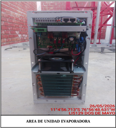
AREA DE UNIDAD EVAPORADORA
